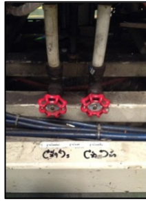
รูปที่ 8: วาล์วปรับแรงดันลมก่อนปรับปรุง
