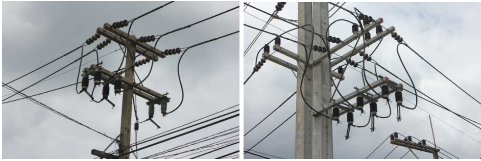
รูปที่ 3: การติดตั้งสวิตช์ตัดตอนเชื่อมโยงในระบบจำหน่าย
